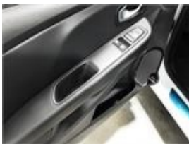
Détail du dommage : Habitáculo Type de dommage : C/ desgaste Taille du dommage : Ver Imagem
